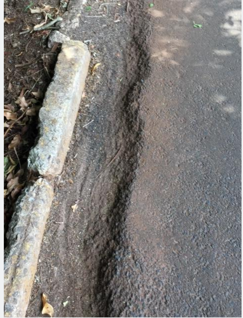
Deformidades no asfalto
